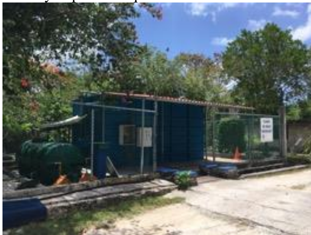
Figura 58. Planta de tratamiento de aguas residuales en operación en Laguna Chankanaab (fotografía Arturo Balderas Torres).
