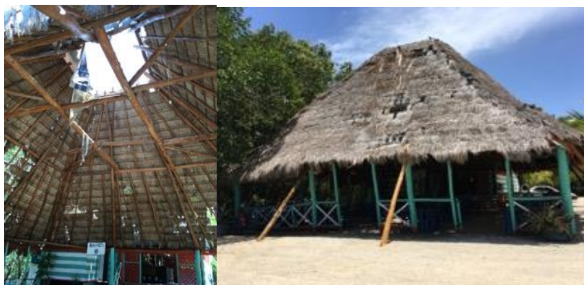
Figura 51. Restaurante con palapa en mal estado en Sistema Lagunar Chacmochuch (fotografías Arturo Balderas Torres).
